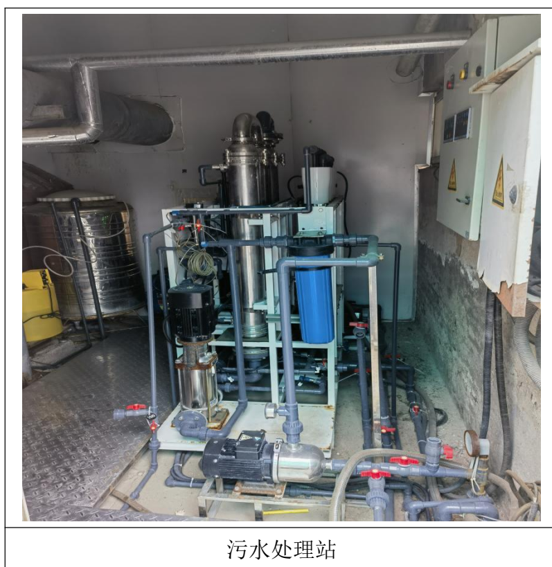
图 5.1-1 污水处理站照片
